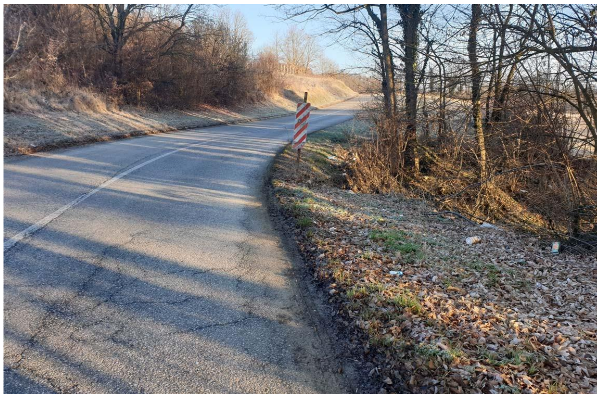
Slika: S gornjih kota padine iznad ceste površinske vode se slijevaju na čelo klizišta
