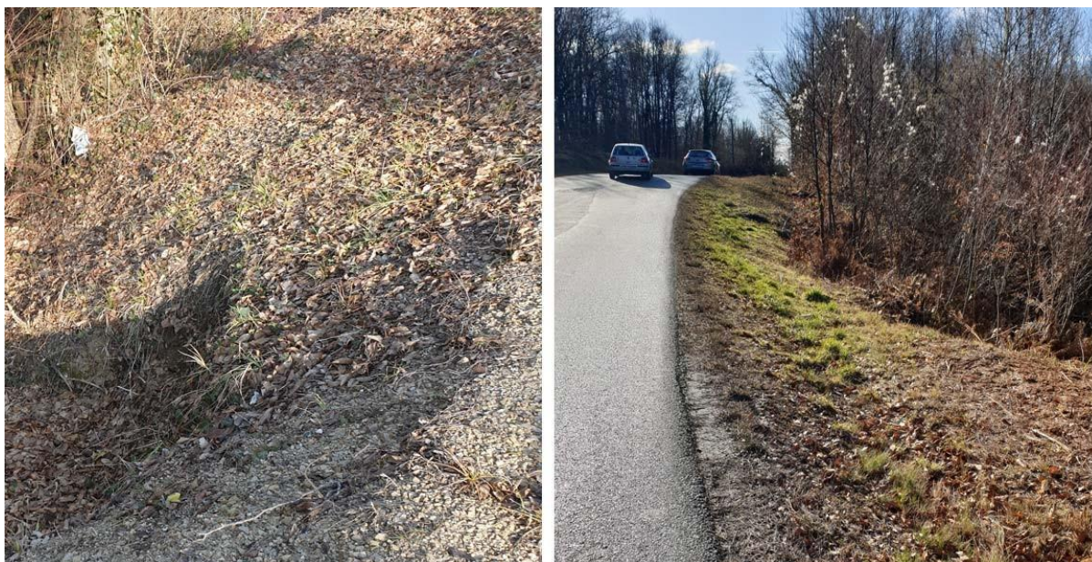
Slika: Županijska cesta ŽC 3155; Stacionaža: 4+050; Puzanje je vidljivo na širim površinama u obje strane ceste
